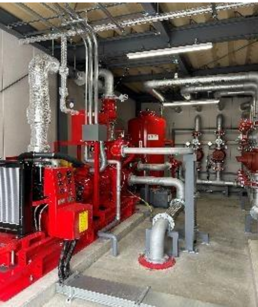
消火ポンプ室
